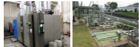
ボイラー 福崎工場の水処理施設
