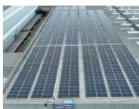
ファクトリー2(インドネシア) 工場屋上の太陽光パネル
