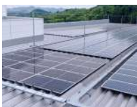
福岡工場 新生産棟屋上の 太陽光パネル
