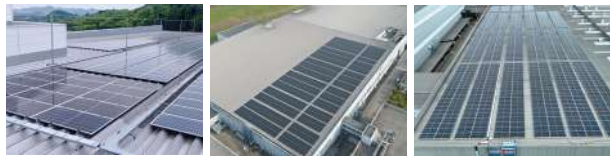
福岡工場 新生産棟屋上の太陽光パネル ファクトリー1（インドネシア）工場屋上の太陽光パネル ファクトリー2（インドネシア）工場屋上の太陽光パネル
